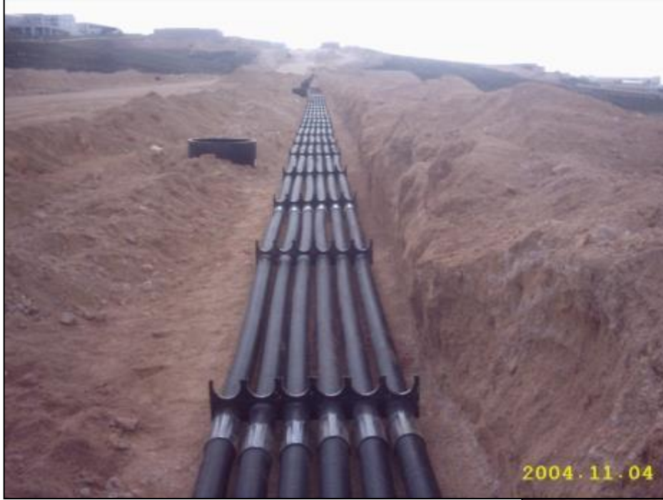
Elektrik Orta Gerilim Hat Kanalları Medium Voltage Power Line Conduits
